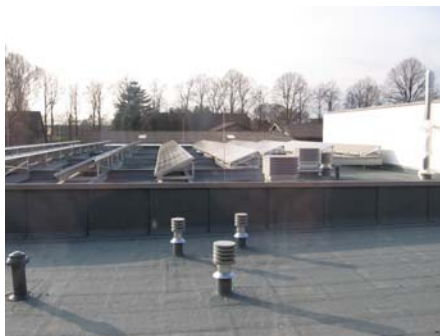
Energieerzeugung auf dem Dach
