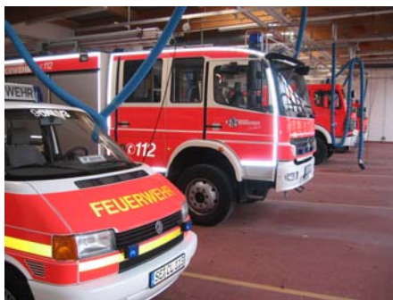
Stellplätze mit Absauganlage
